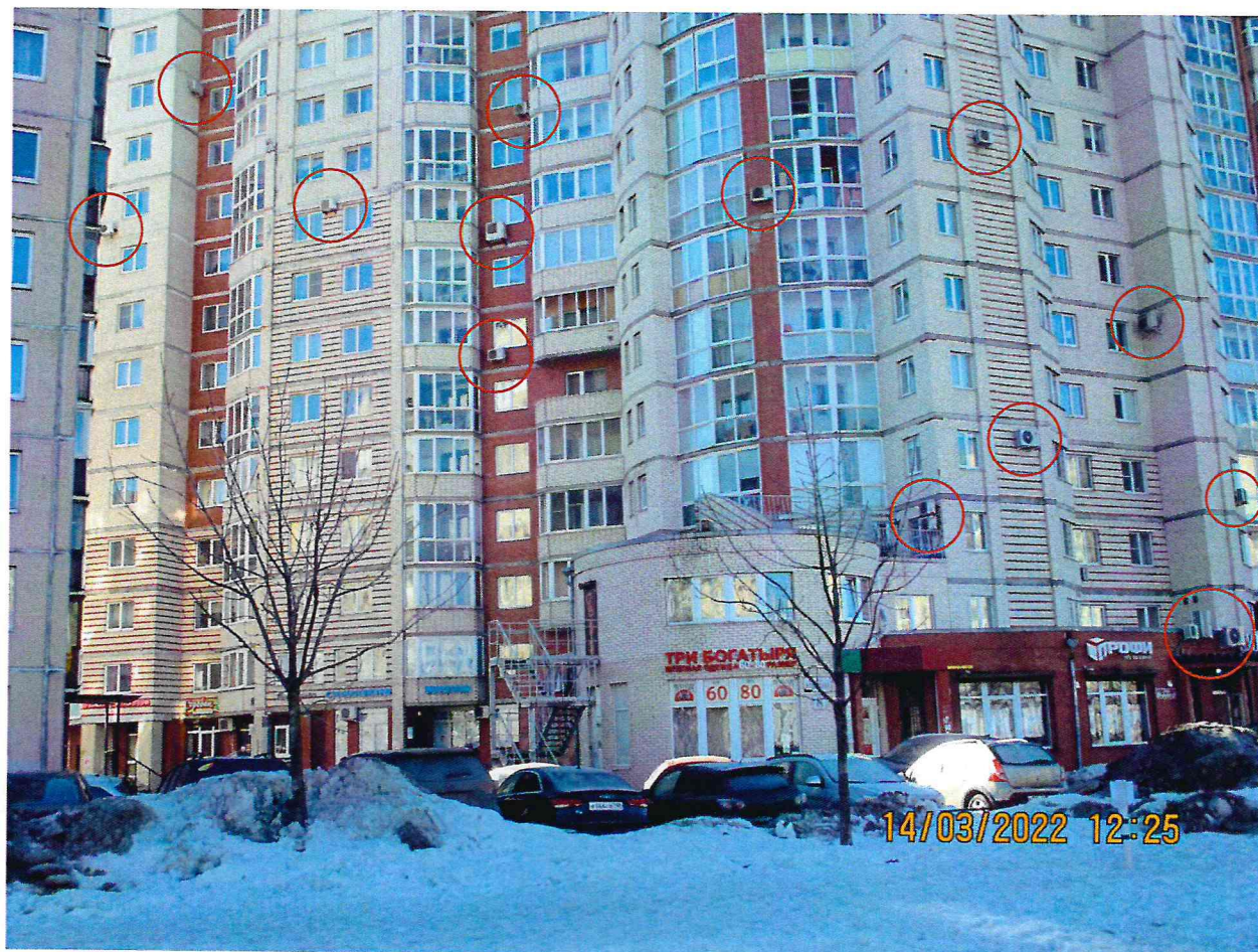
Инженерное и техническое оборудование – наружные блоки систем кондиционирования и вентиляции.
